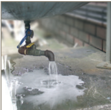
Verunreinigungsquelle Nr. 4 Die Verteilerleitungen
