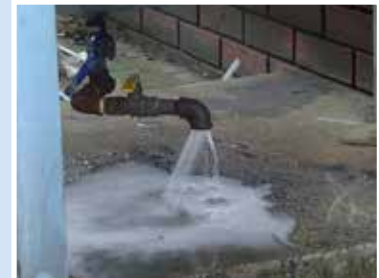
Druckluftkondensat aus einem Luftbehälter
